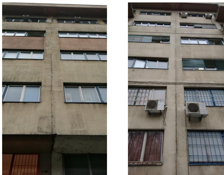
Slika 4.18. Pogled na razdjelnicu s prednje i stražnje strane zgrade
