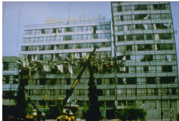
Slika 3.12. Otkazivanje zgrade zbog sudaranja prilikom potresa u Mexico City-u 1985. godine [19]
