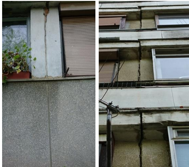
Slika 4.24. a) neoštećena razdjelnica b) pukotine na kontaktu dilatacija
