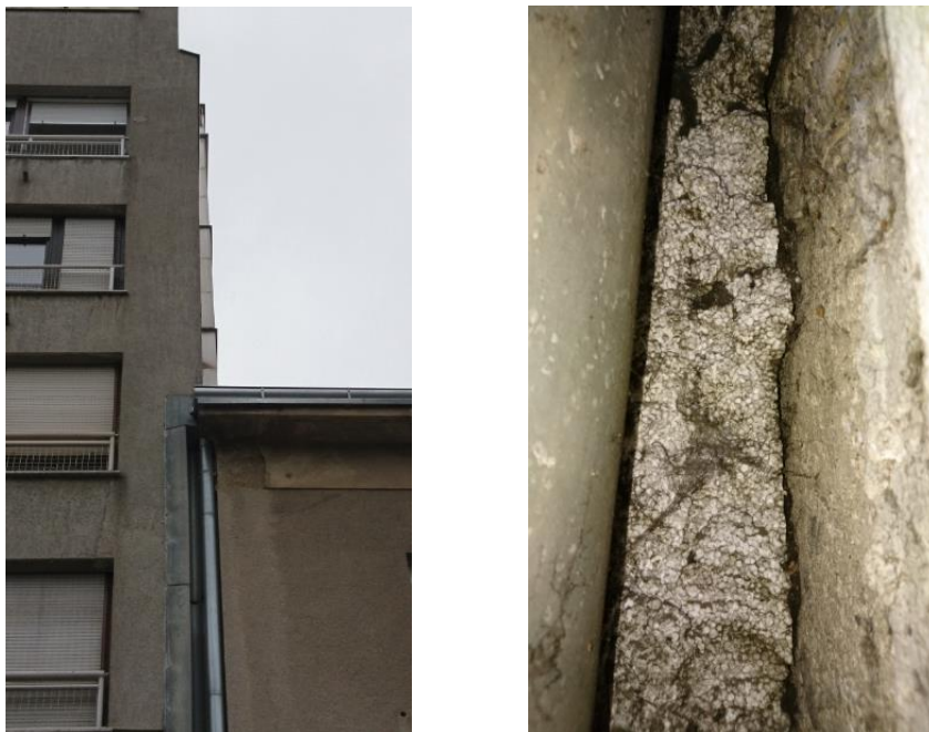
Slika 3.8. Stiropor u razdjelnici obložen limom na vanjskoj fasadi
