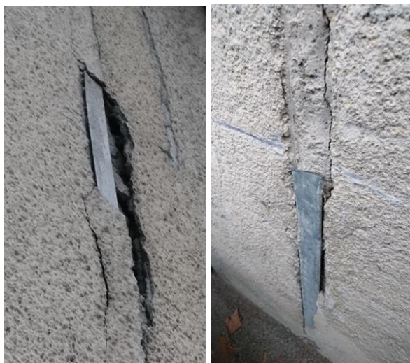
Slika 4.19. Lim i pukotine oko razdjelnice
