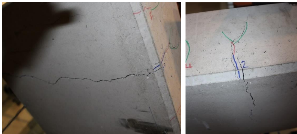
Slika 53. Prikaz glavne pukotine
