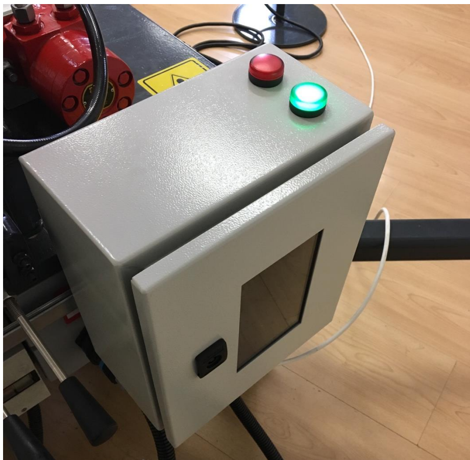
Slika 2.11. Slika upravljačkog ormara s uključenim napajanjem
