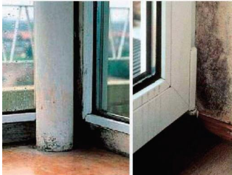
Slika 18. Razvoj gljivica oko prozora zbog kondenzacije vodene pare [1]
