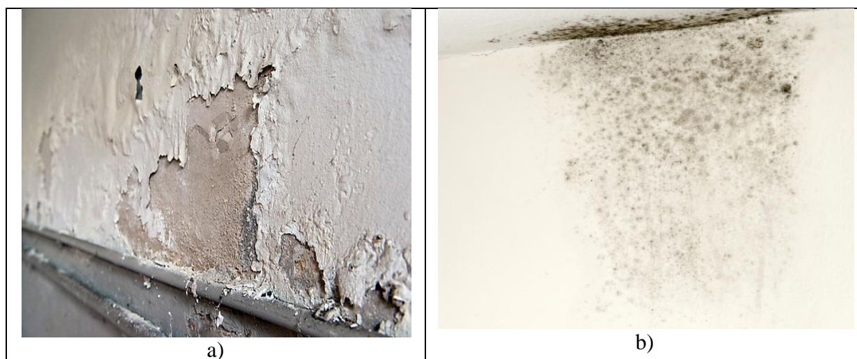
Slika 12 Građevinske štete na zidovima zbog djelovanja vlage: a) ljuštenje završnog sloja zida; b) pojava plijesni i gljivica na zidu[21]
