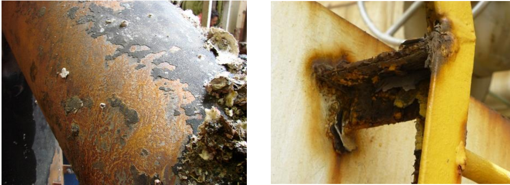
Slika 2. Primjeri degradacije premaza
