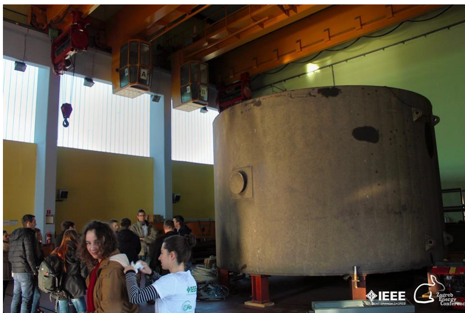
Slika 9 Postrojenje hidroelektrane Čakovec
