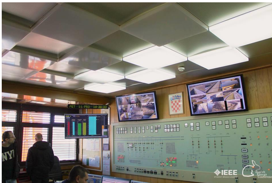
Slika 8 Komandni centar Hidroelektrana Sjever
