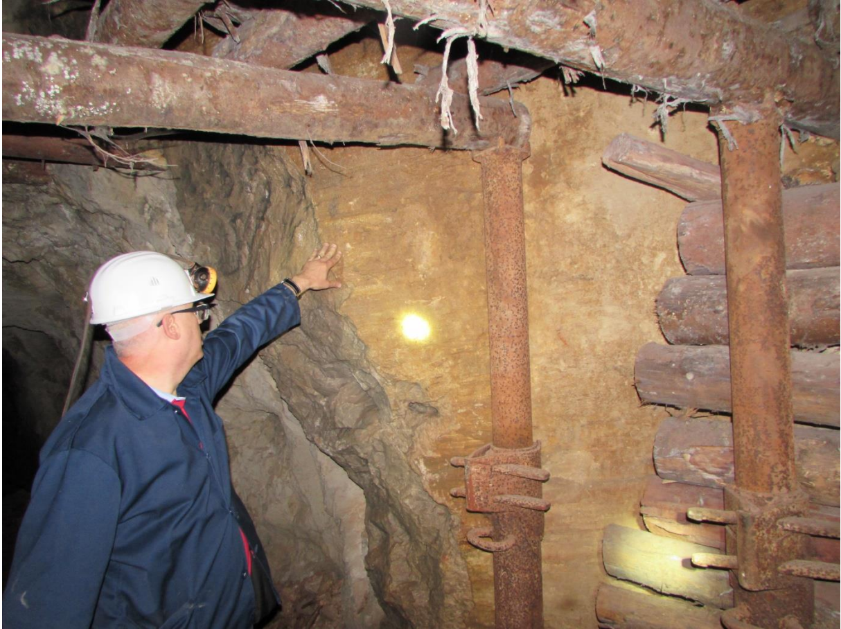
Slika 6.12. Rasjed prikazan na slici 6.11. snimljen je u potkopu na koti 900.
