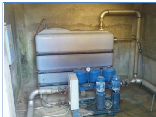
Slika 30 Hidroblok crpne stanice
