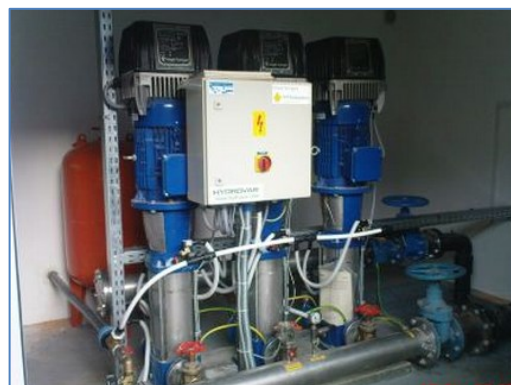
Slika 34 Hidroblok crpne stanice
