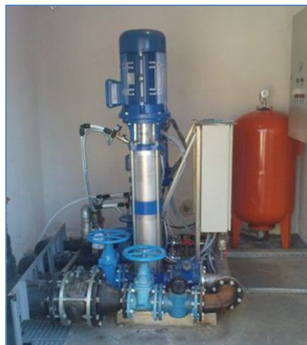
Slika 26 Hidroblok crpne stanice
