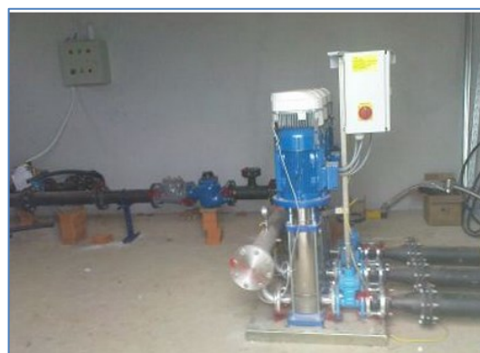
Slika 37 Hidroblok precrpne stanice
