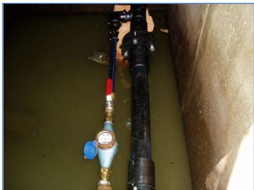
Slika 18 Primjer kućnog priključka vodoopskrbne mreže Kuitna - Popovača
