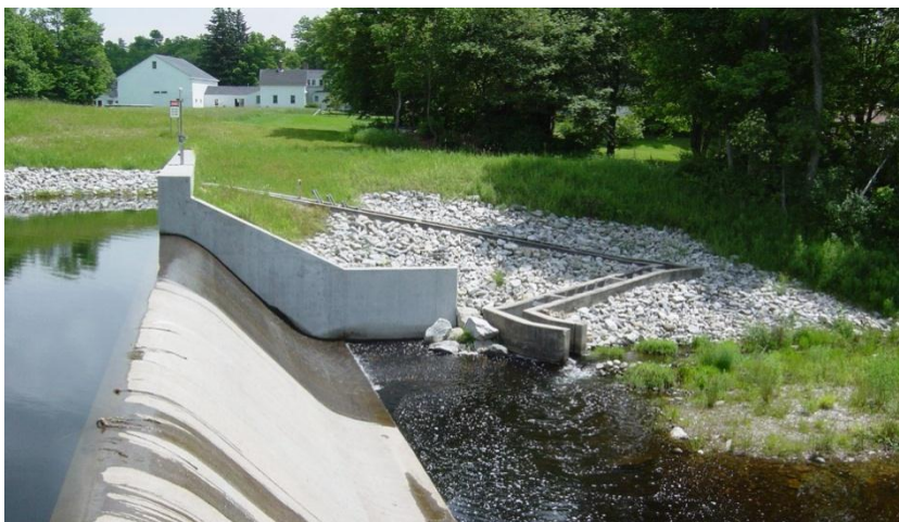
Slika 1. Prag male hidroelektrane sa ribljom stazom [6]
