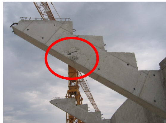
d) segregacija betona i pojava „gnijezda“ koja dovodi do oslabljenja konstrukcije
