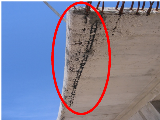
c) utjecaj propadanja armature na oplatu, čest slučaj kod armiranobetonskih zbog vibriranja i hoda radnika po armaturi za vrijeme ugradnje betona
