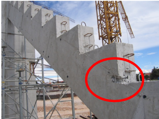
a) utjecaj ljudskog faktora na vibriranje običnog betona te pojava mjesta u oplati na koja beton nije ugrađen
