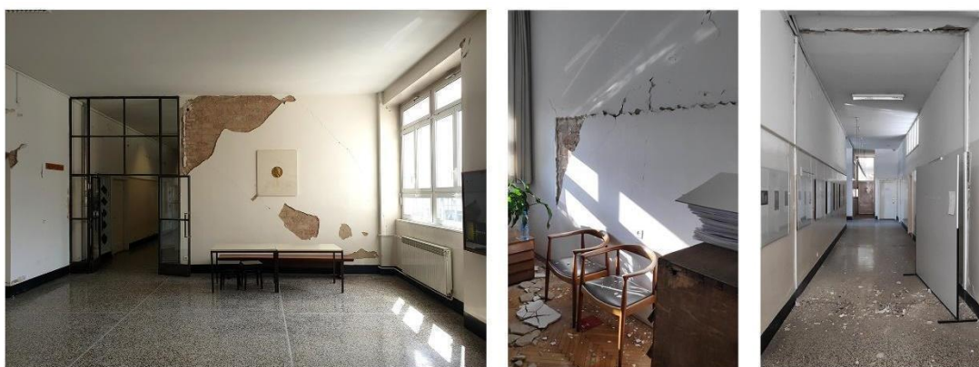
Slika 20 - kat zgrade fakulteta nakon potresa
