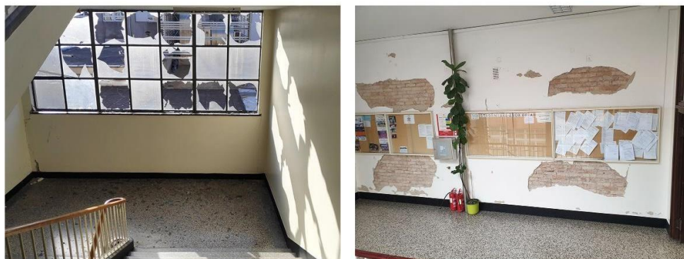
Slika 19 - stubište i 1. kat zgrade fakulteta nakon potresa
