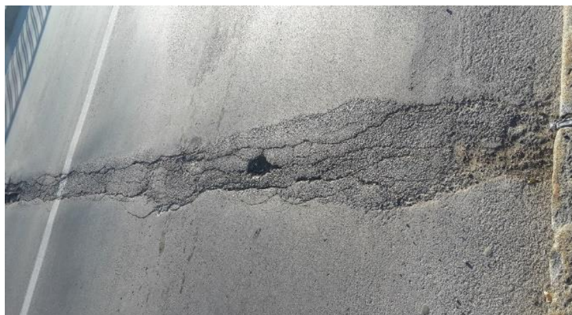
Slika 45. Dilatacija i pukotine na kolniku
