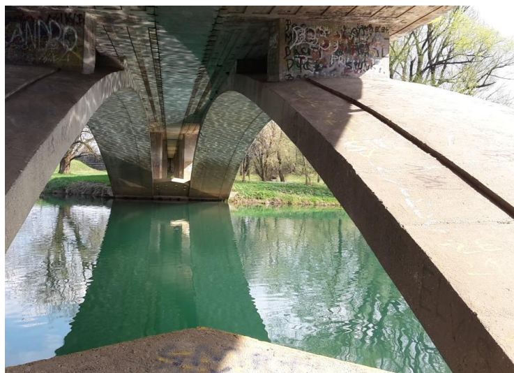
Slika 48. Lučna konstrukcija mosta s neznatnim oštećenjima
