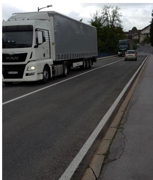
Slika 17. Mrežaste pukotine na pješačkom hodniku
