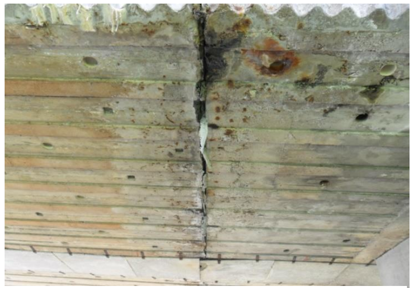
Slika 46. Dilatacija i iscvjetavanje na glavnom nosaču
