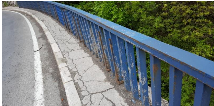
Slika 24. Korozija ograde, oštećenje hodnika
