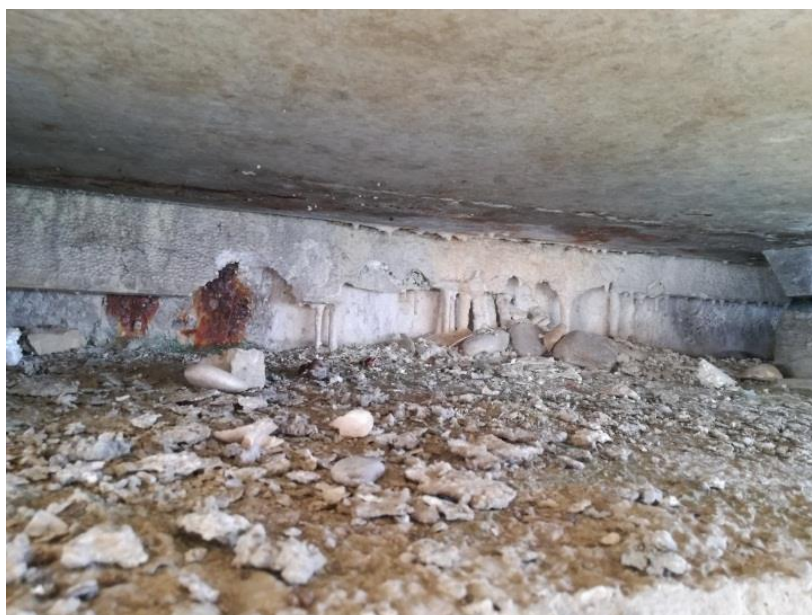
Slika 58. Izluživanje betona na upornjaku
