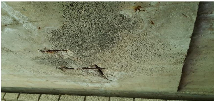
Slika 28. Segregacija betona i korozija armature u podgledu na ploču u polju neposredno uz drugi upornjak
