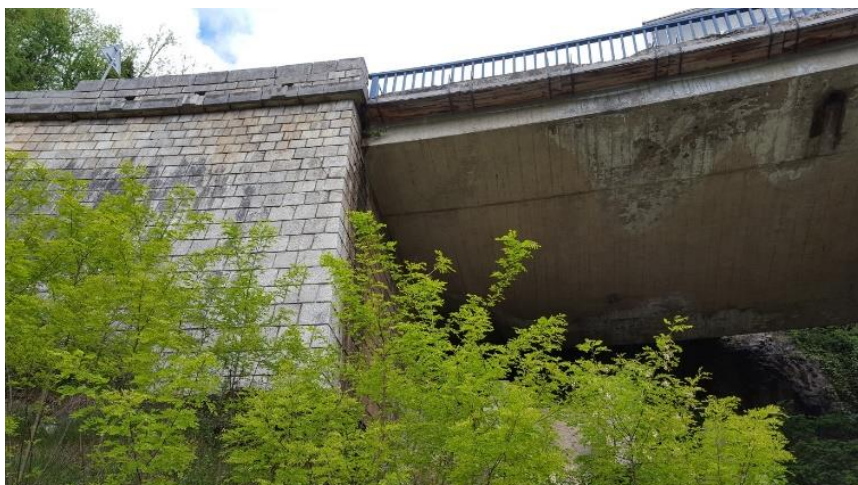
Slika 27. Iscvjetavanje betona u podgledu nosive pločaste konstrukcije mosta blizu prvoga upornjaka
