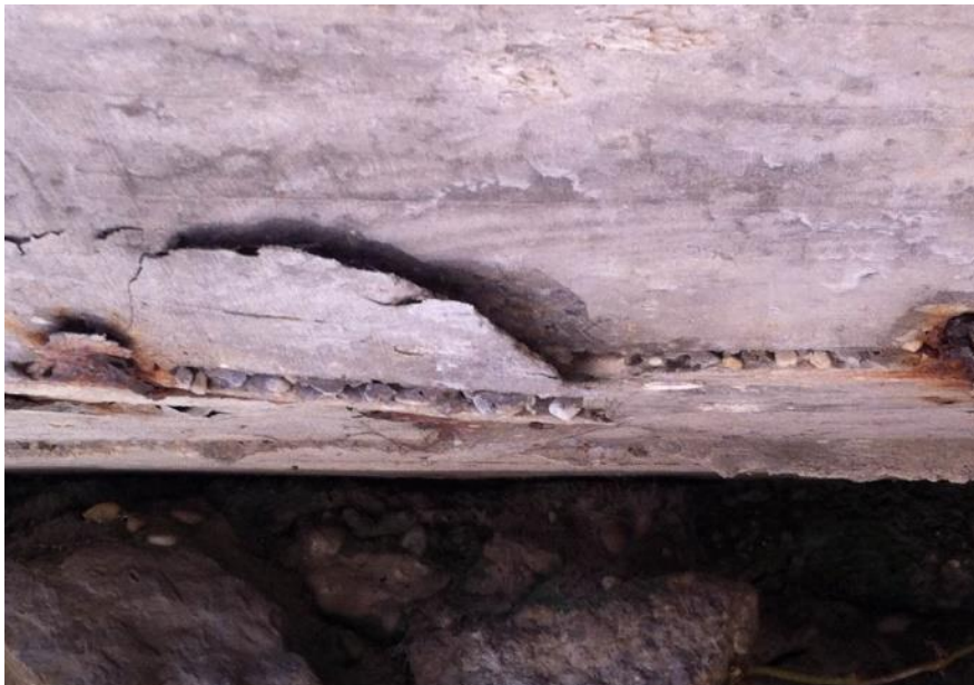
Slika 37. Prikaz odlamanja betona ploče
