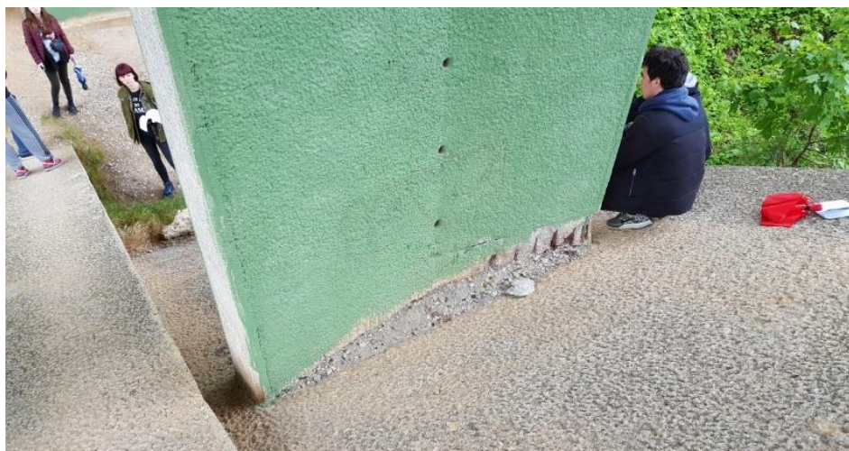
Slika 16. Korozija i odlamanje zaštitnog sloja betona na stupu
