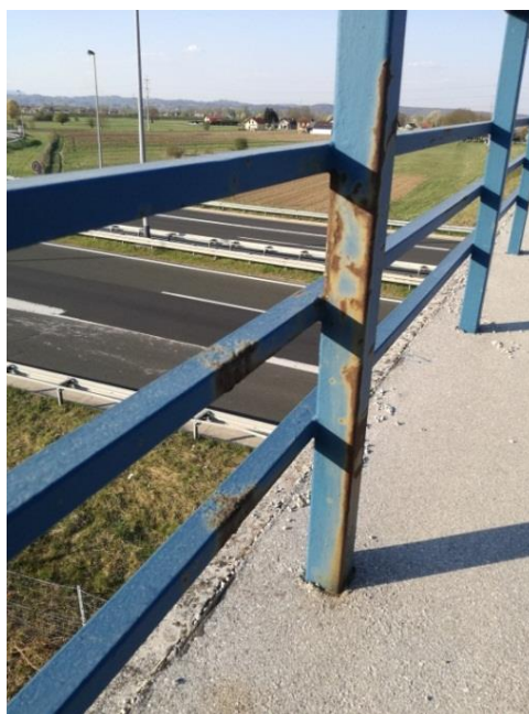
Slika 54. Korozija pješačke ograde
