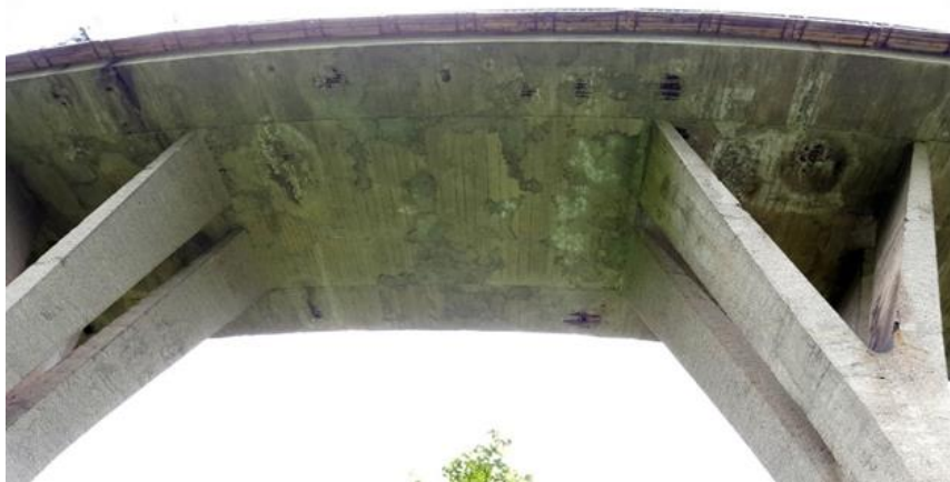
Slika 26. Odlamanje zaštitnog sloja, iscjetavanje betona (dijelom sanirano) na podgledu nosive konstrukcije
