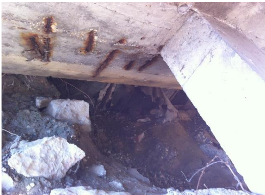
Slika 35. Korozijska armature ploče glavnog nosača
