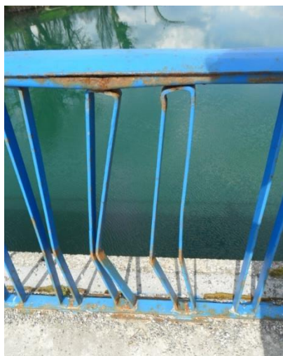
Slika 44. Oštećenje ograde: mehaničko oštećenje i korozija
