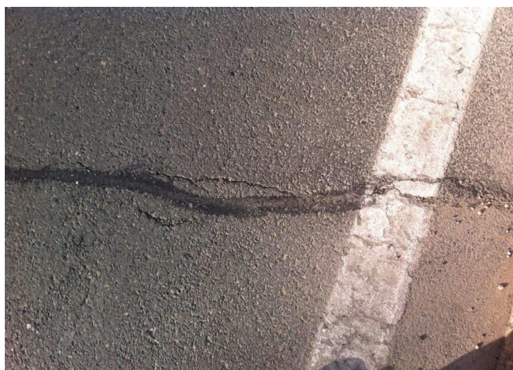
Slika 34. Sanirana, naknadno otvorena pukotina u asfaltu
