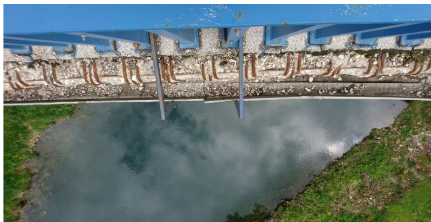
Slika 25. Korozijska armature te odlamanje vijenca
