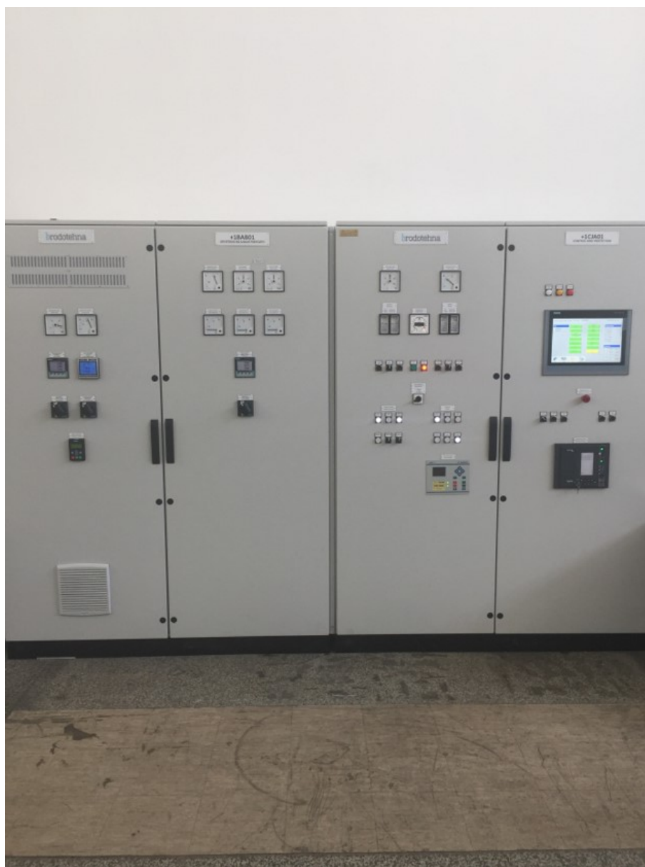
Slika 9. Razvodni i upravljački ormar hidroelektrane
