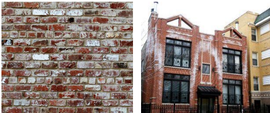
Slika 4. Iscvjetavanje soli na površini zidane građevine [12]
