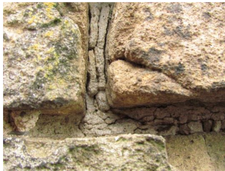
Slika 7. Oštećenja zida uslijed smrzavanja i odmrzavanja [21]
