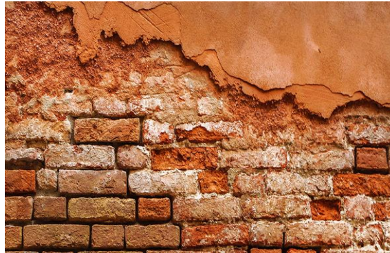
Slika 5. Posljedice subeflorescencije na zidanoj građevini [21]
