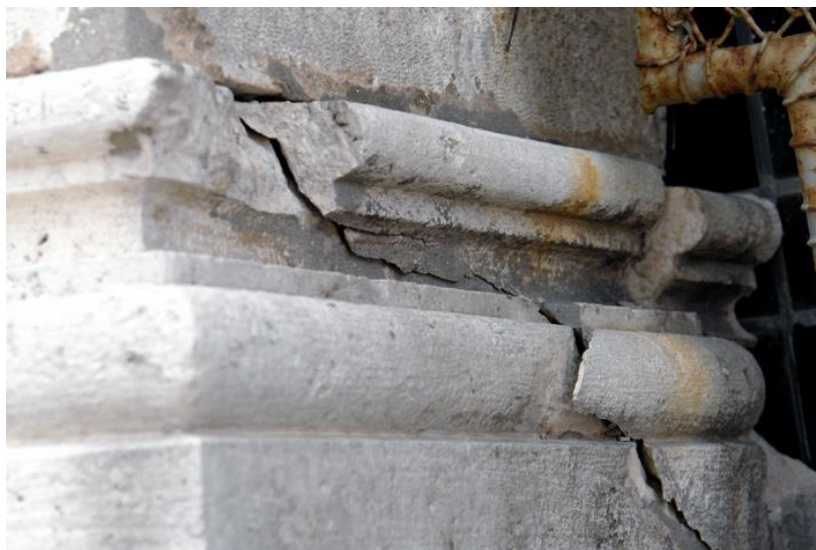
Slika 69 Detalj oštećenja - pukotine u kamenu [30]
