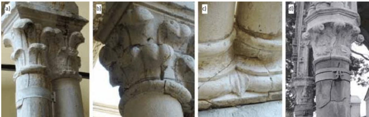
Slika 68 Pukotine na tradicionalnim kamenim stupovima s ostacima prethodnih sanacija [29]
