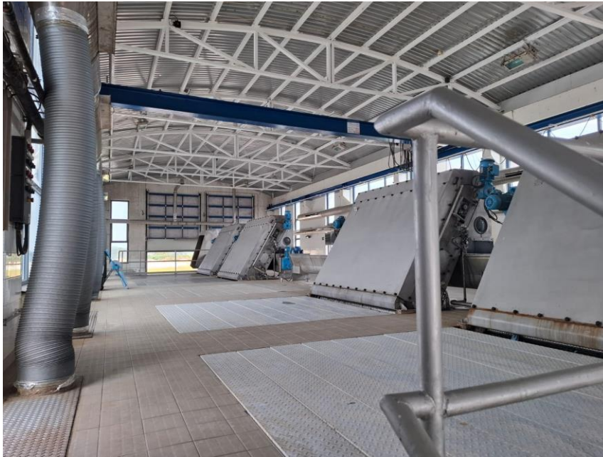
Slika 223. Sustav za mehaničko čišćenje otpadnih voda
