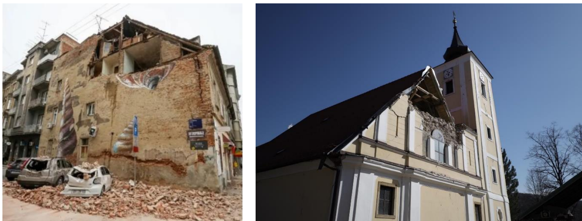
Slika 1.4 – Oštećenja zgrada u potresu [10, 11]
