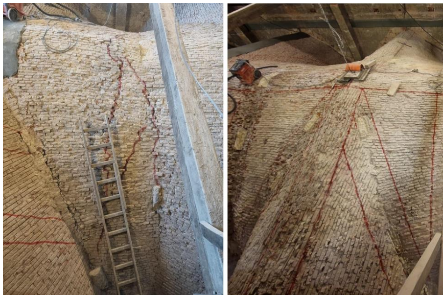
Slika 1.6 Vlačne pukotine u svodu Zagrebačke katedrale
