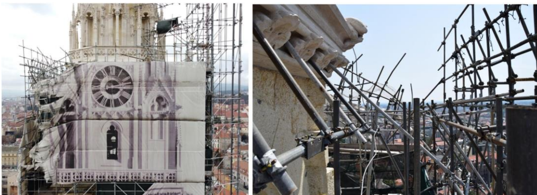
Slika 1.8 Oštećenje skele tornja nakon potresa
