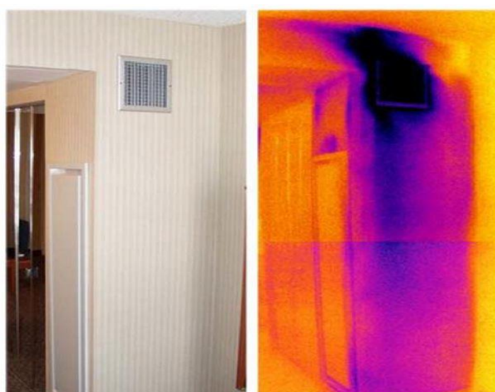
Slika 6. ICT provjere rada sustava grijanje - hlađenje [5]
