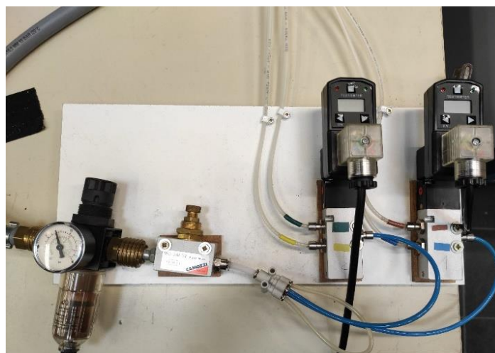
Slika 3.14: Fotografija pneumatskog sustava za upravljanje otvaranja/zatvaranja prozora
