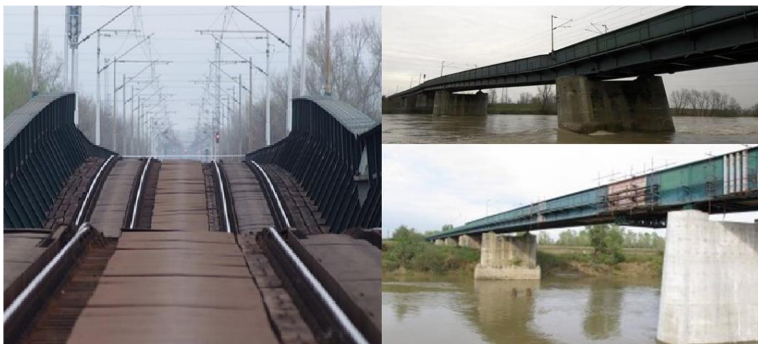
Slika 1. Prikaz mosta Jakuševac nakon havarije, te prikaz mosta nakon sanacije [6, 7, 8]
