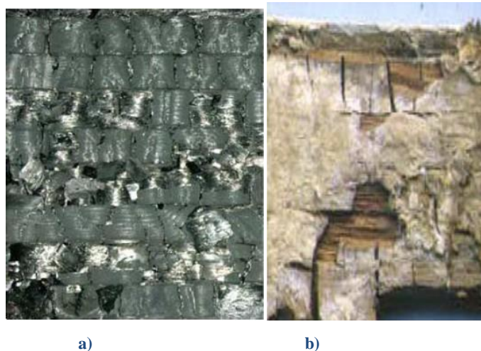
Slika 2.6 Prikaz oštećenja uslijed a) požarnog djelovanja b) napada gljivica
