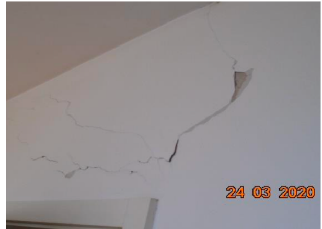
Slika 8.2 Pukotine iznad vrata u sobi D207 [2]
