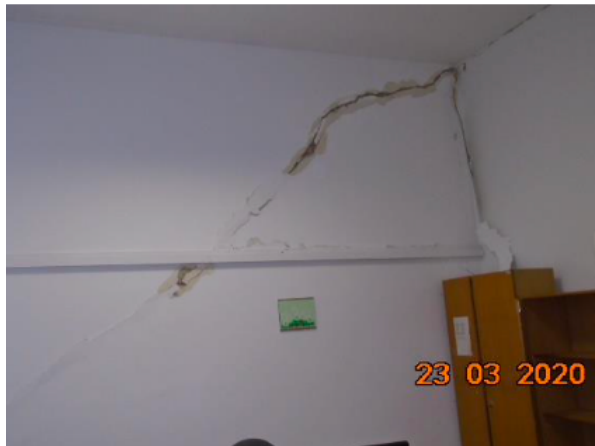
Slika 8.1 Pukotina na zidu u sobi D115 [2]
