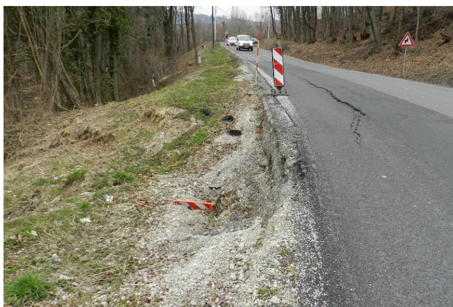
a) pukotine na cestama i odlamanje dijelova asvalta
