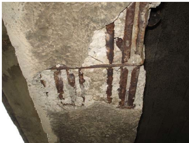
Slika 5 Primjer posljedica eksplozivnog odlamanja armirano-betonskog elementa izloženog visokim temperaturama [15]
