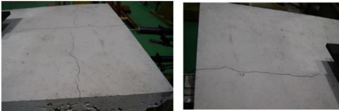
Slika 1.12. Pukotine na betonskoj ploči nakon provedenog ispitivanja [12]
