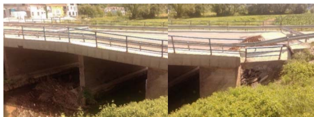
Slika 4. Most „Đurmanec“ nakon gubitka stabilnosti [18]
