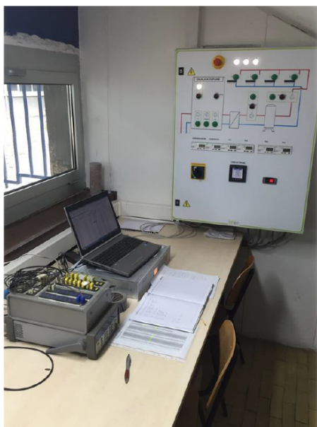
Slika 11: Mjerna oprema u tehničkoj sobi
