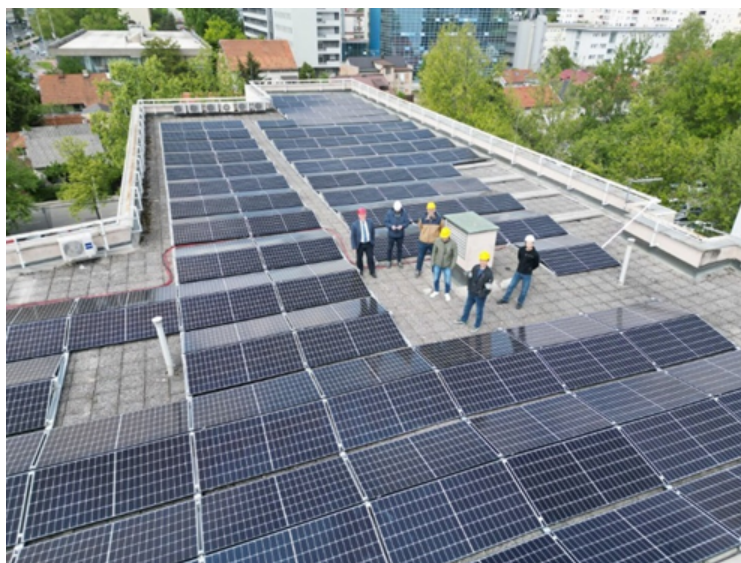
Slika 7 Sunčana elektrana na krovu zgrade Fakulteta elektrotehnike i računarstva
